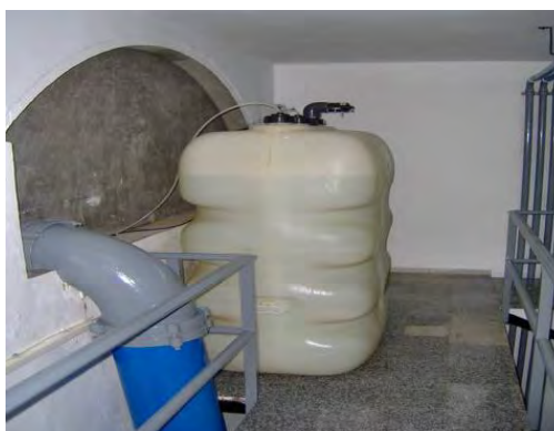
Dipòsit de Hipoclorit Sòdic
