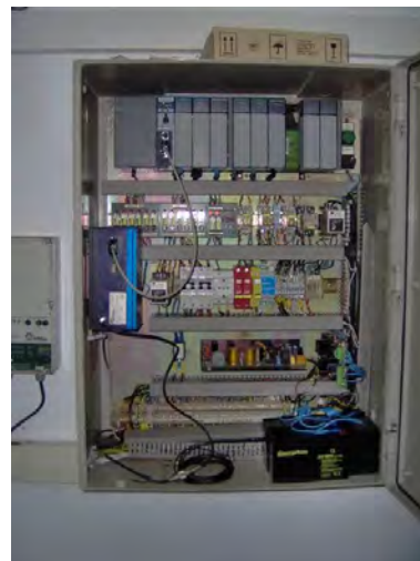
Quadre PLC i Ràdio-Mòdem
