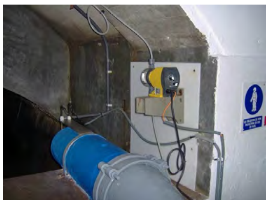
Dosificador de Hipoclorit Sòdic
