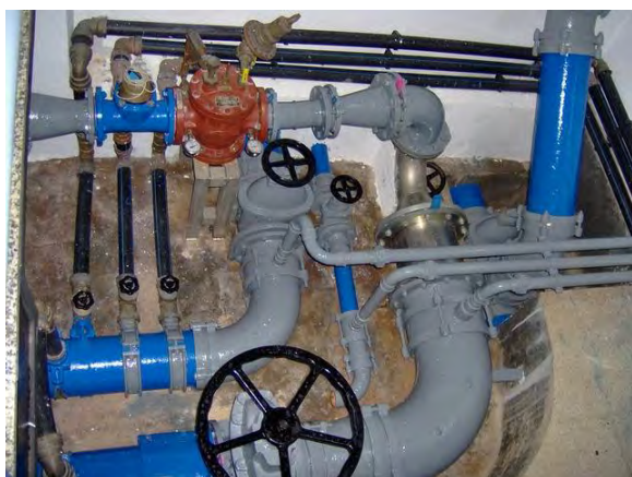
Conjunt de vàlvules del By-pass
